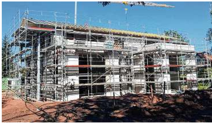
An den Tagen des Passivhauses können Besucher auch das sich im Rohbau befindliche Mehrfamilien-Passivhaus der BHV in der Buchenberger Straße 21 in Königsfeld besichtigen. BILDER: ARCHITEKTURBÜRO KETTERER
